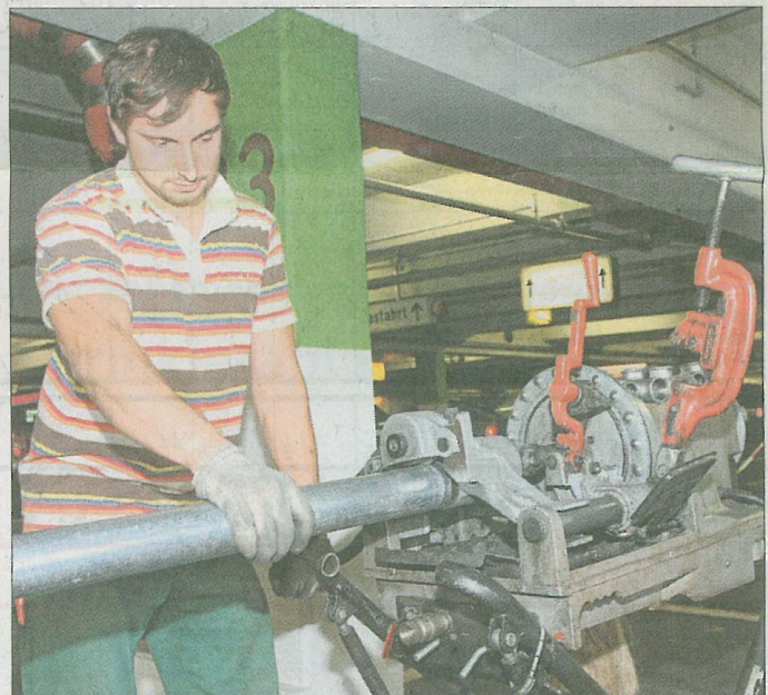
Auch nachts wird an der Erneuerung der vielen Bauteile gearbeitet, der Betriebsablauf wird kaum gestört.
