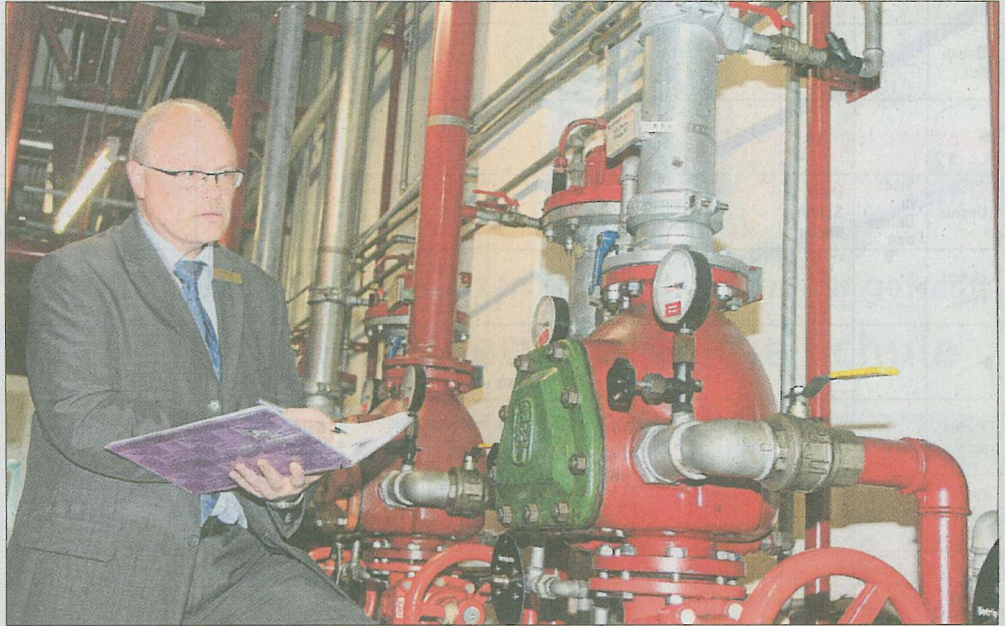
Hausinspektor Heinz Paul Bretz in der Zentrale der Sprinkleranlage des Löhr-Center.
